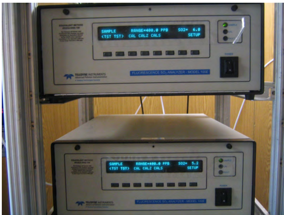
Abbildung 6: Frontaufnahme der im Messcontainer installierten Messeinrichtungen
