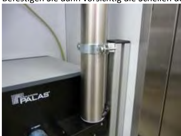
Abbildung 19: Interne Fixierung des Probenahmerohres
