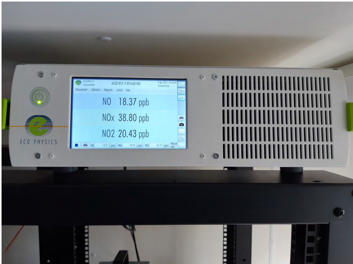
Abbildung 6: nCLD 855 Y in der Feldmessstation
