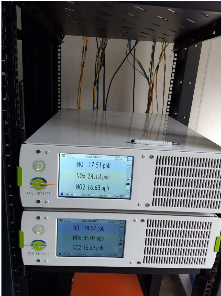
Abbildung 9: nCLD AL 2 in der Messstation während des Feldtests
